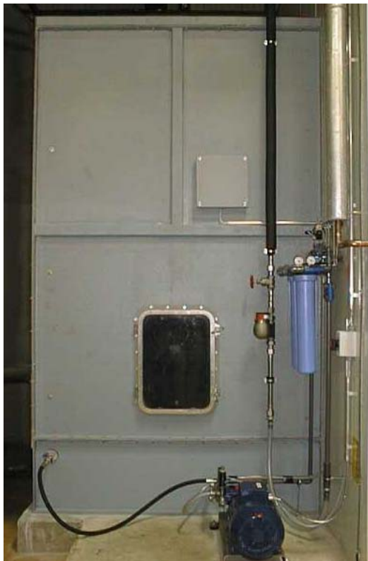
Gehäuse mit Pumpen- und Filterstation
